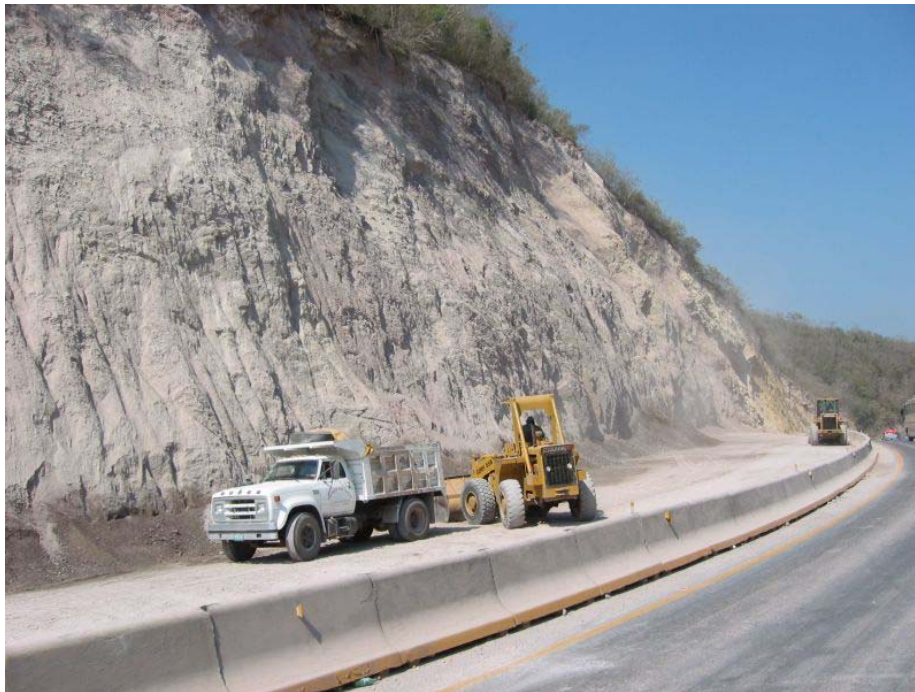
Figura 5 Derrumbes en Autopista 110 entre Manzanillo y Colima
