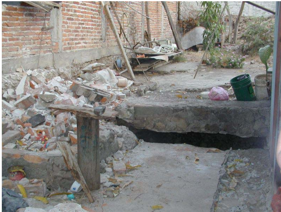
Figura 7 Asentamiento local de suelos, Villa de Álvarez
