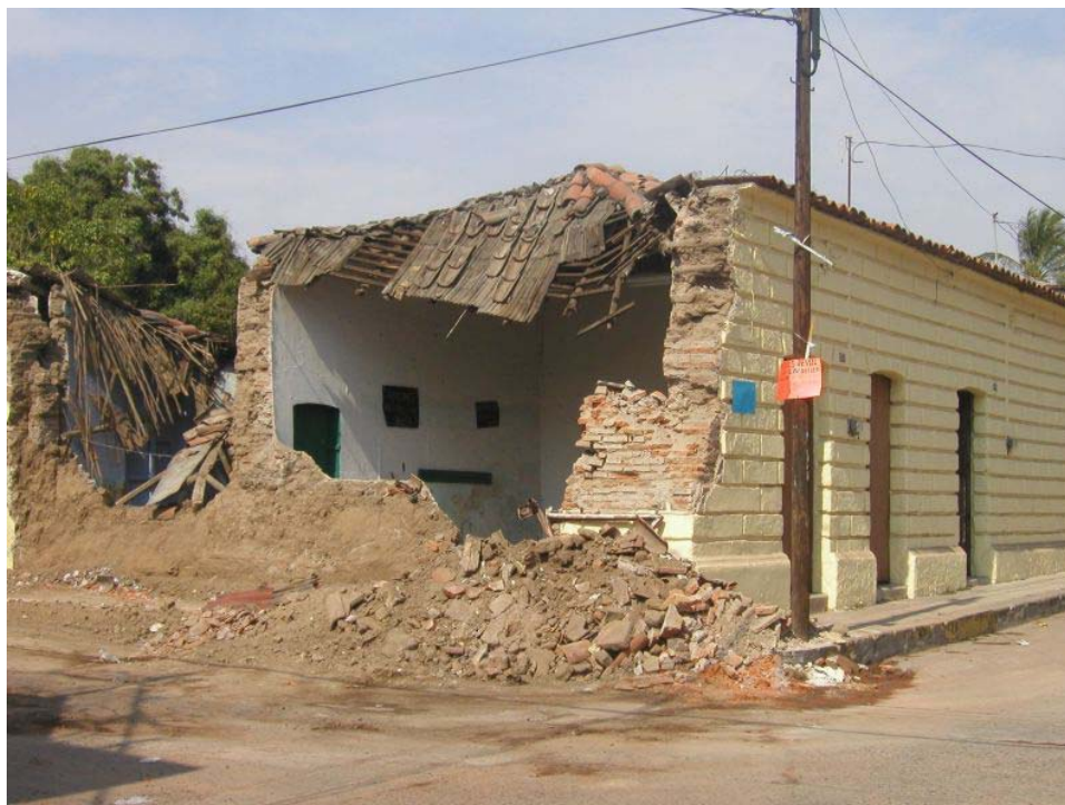
Figura 9 Daños típicos a estructura esquinera de adobe
