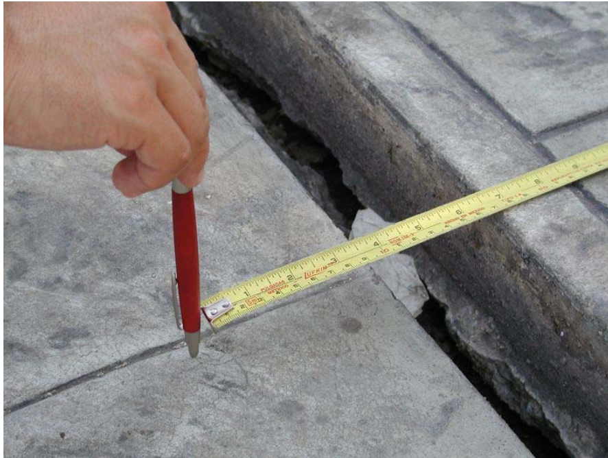
Figura 4 Asentamiento en estacionamiento, Muelle Municipal, Manzanillo
