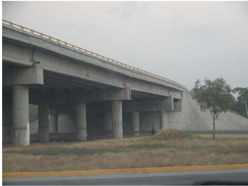
Figura 6 Daños a puente
