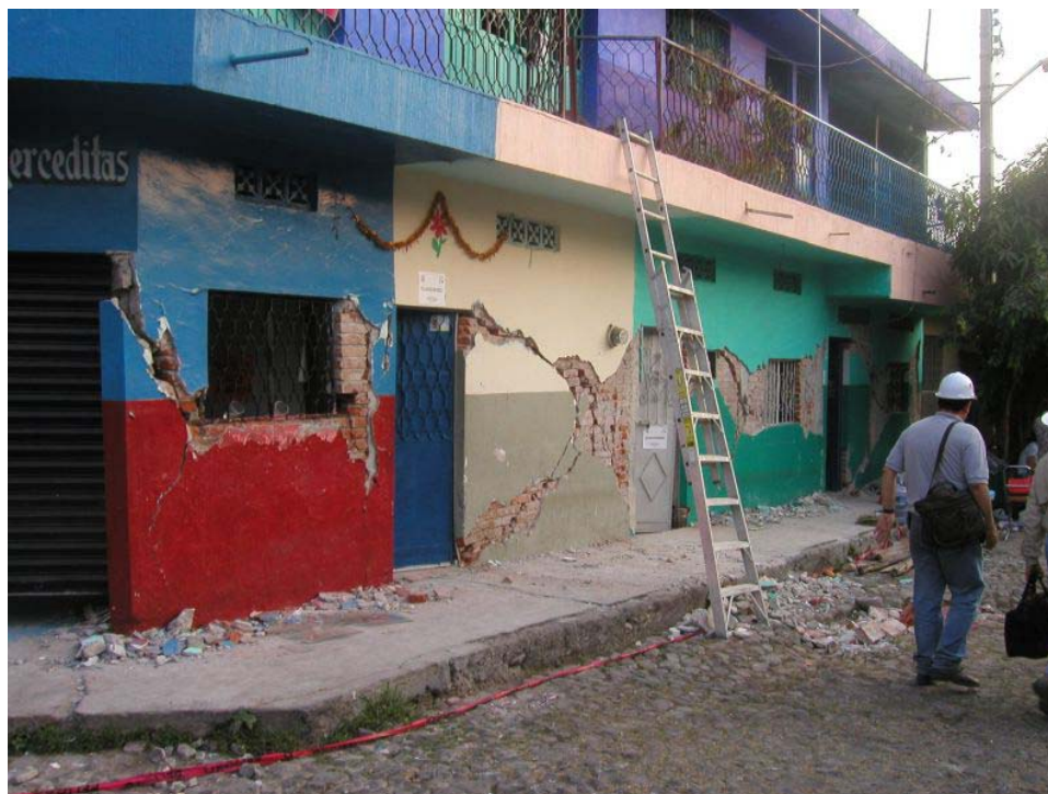
Figura 8 Daños comunes en la mampostería no reforzada
