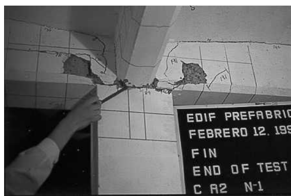
Figura 3. Daño observado al final del ensaye en la conexión trabe-columna de eje central
