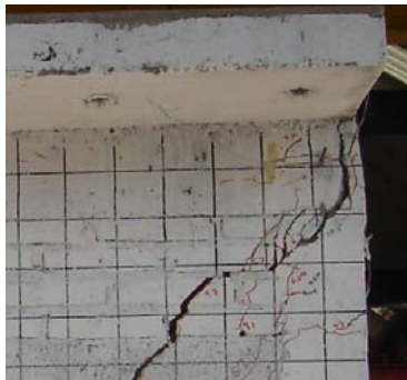
a) Grieta en castillo, extremo superior
