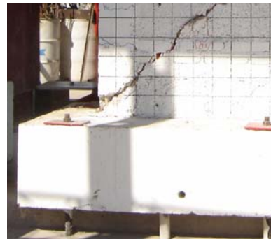
b) Grieta en castillo, extremo inferior
